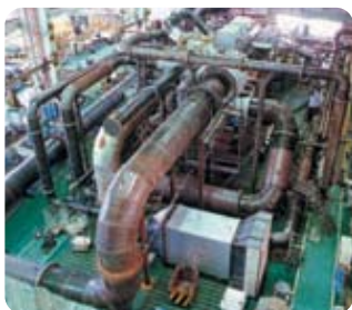
ギアドコンプレッサ (PTAプラント用)
