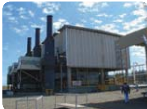
パイプラインステーション
