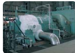
冷凍コンプレッサ・蒸気タービン
