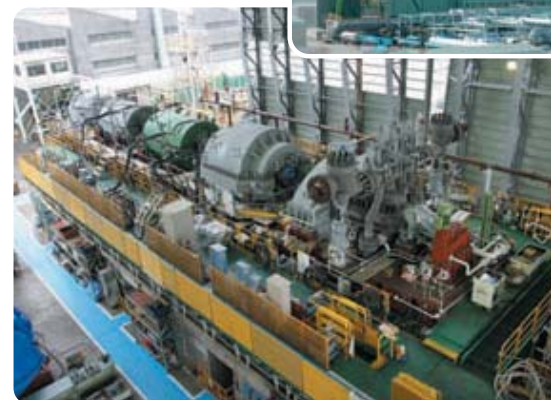
超大型コンプレッサ用屋外テストスタンド
